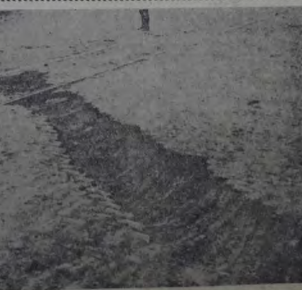
SE PRESENTA EN NO POCAS CALLES DE LA CIUDAD DE LA PLATA, COMO CONSECUENCIA DEL estado en que quedan después de obras que se realizan con distintos fines. El grabado muestra la esquina de la diagonal 74 al llegar a la 20. En medio de la calzada y cubriendo todo su ancho, una zanja que ha sido malamente rellenada, y abierta para la ampliación de las aguas corrientes, deja la calle intransitable, con grandes perjuicios para los que deben, forzosamente, pasar por allí.
